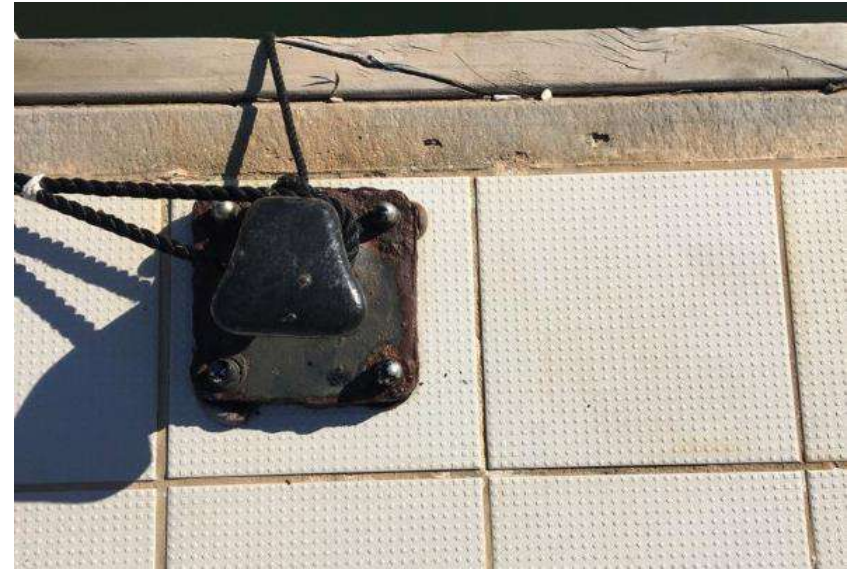
Después de tratamiento con G200 ÓXIDO
