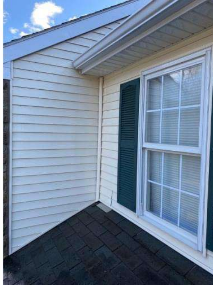
Después de tratamiento con G200 ÓXIDO
