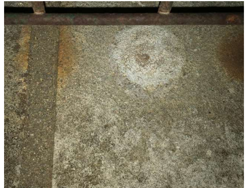
Después de tratamiento con G200 ÓXIDO
