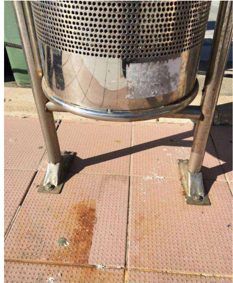
Después de tratamiento con G200 ÓXIDO
