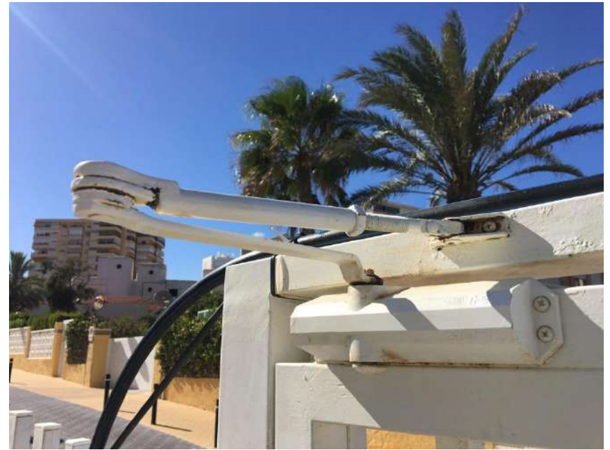
Después de tratamiento con G200 ÓXIDO
