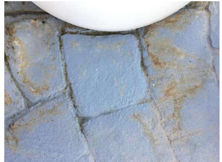
Después de tratamiento con G200 ÓXIDO
