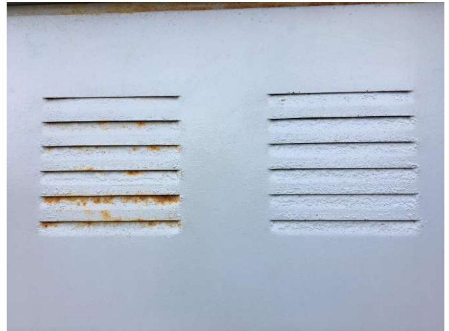
Después de tratamiento con G200 ÓXIDO
