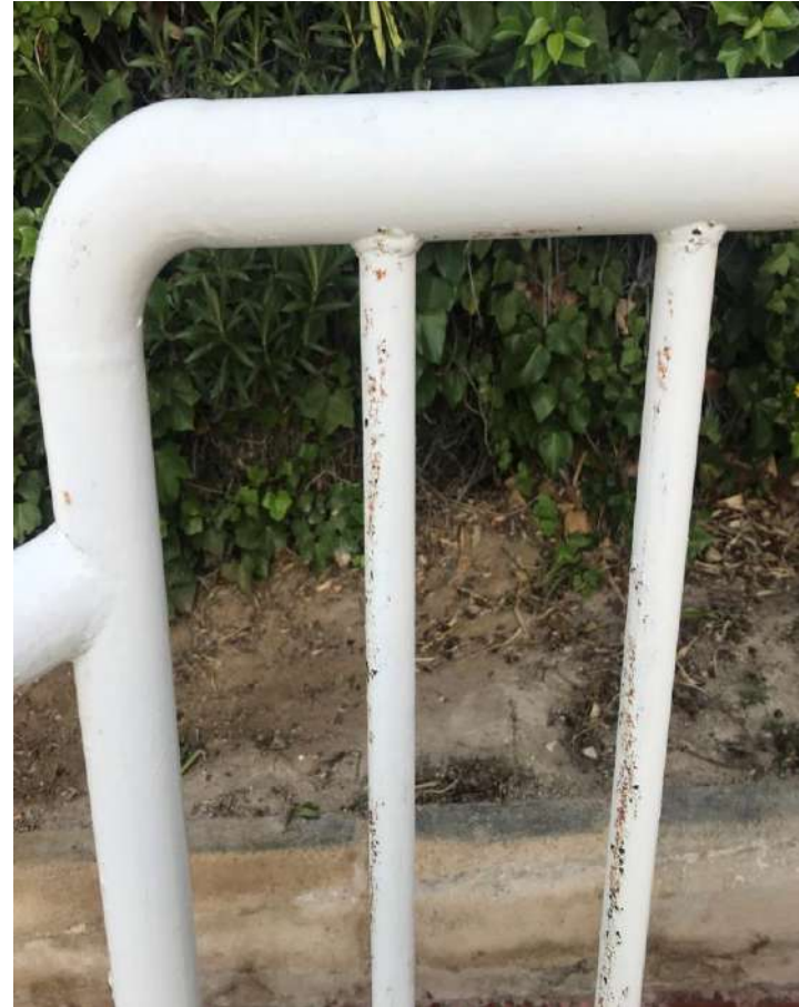
Después de tratamiento con G200 ÓXIDO
