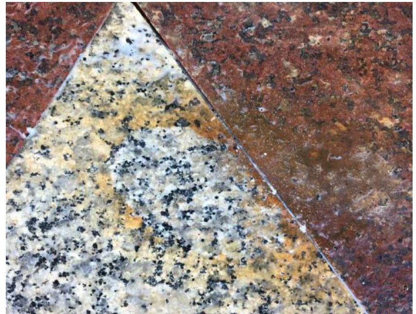
Después de tratamiento con G200 ÓXIDO
