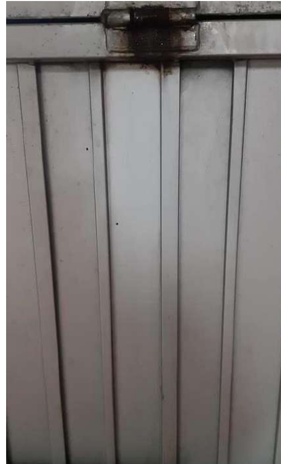
Después de tratamiento con G200 ÓXIDO
