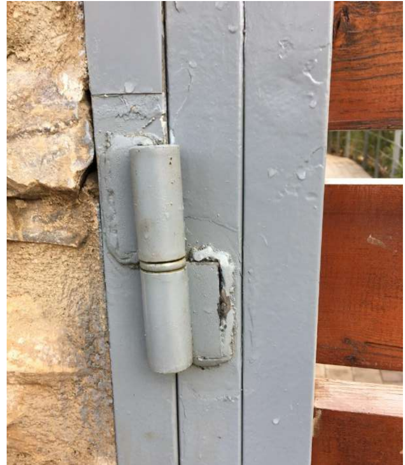
Después de tratamiento con G200 ÓXIDO
