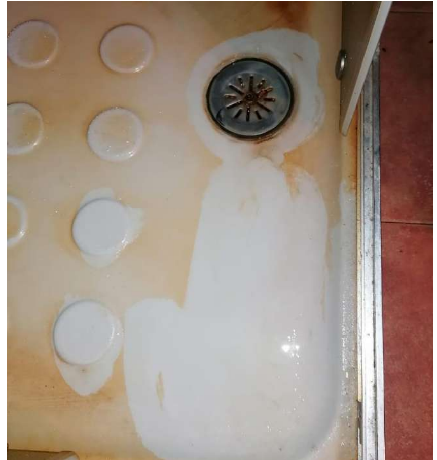
Después de tratamiento con G200 ÓXIDO
