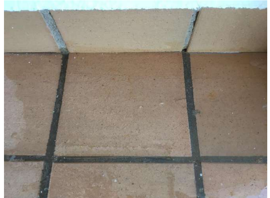
Después de tratamiento con G200 ÓXIDO
