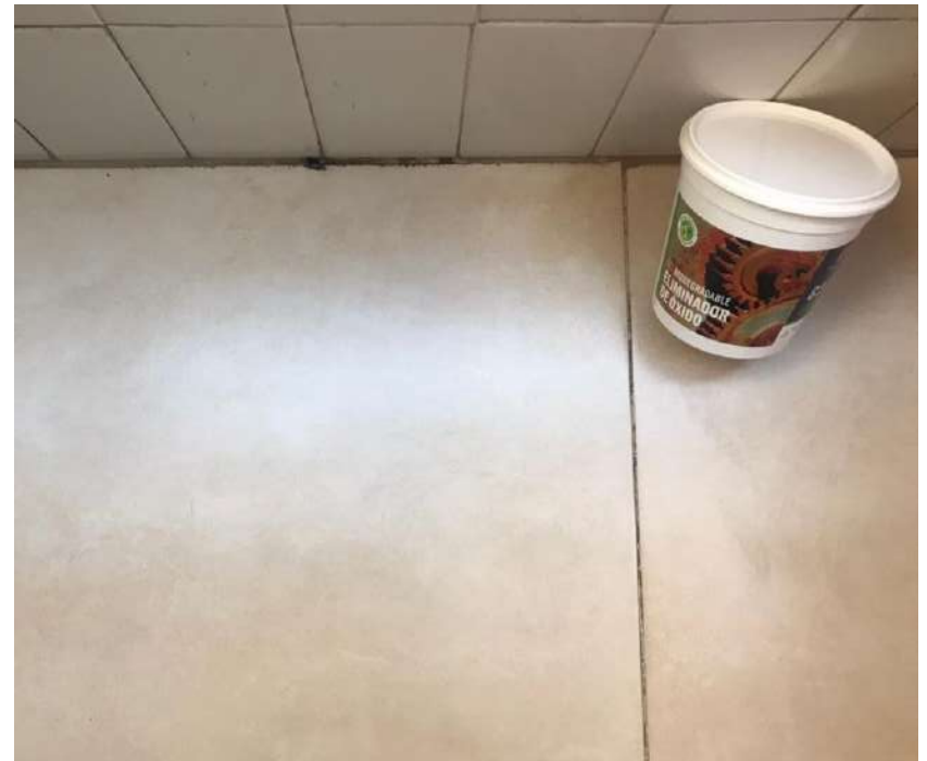
Después de tratamiento con G200 ÓXIDO
