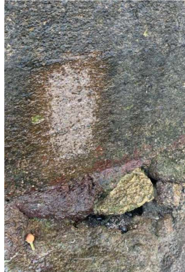
Después de tratamiento con G200 ÓXIDO
