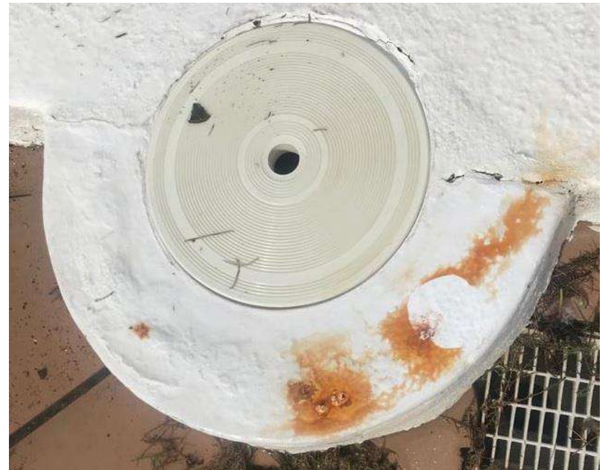
Después de tratamiento con G200 ÓXIDO
