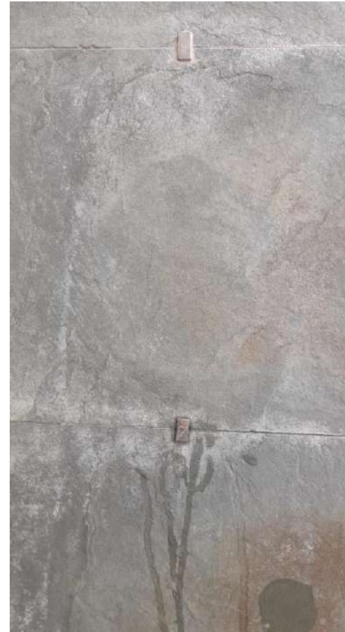
Después de tratamiento con G200 ÓXIDO
