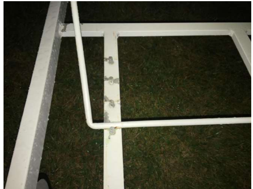
Después de tratamiento con G200 ÓXIDO
