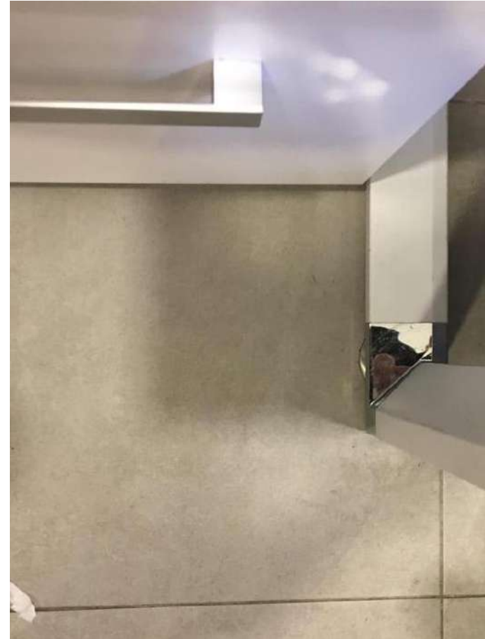
Después de tratamiento con G200 ÓXIDO
