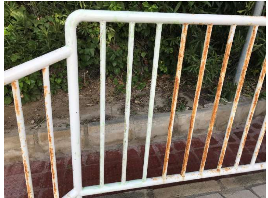
Después de tratamiento con G200 ÓXIDO
