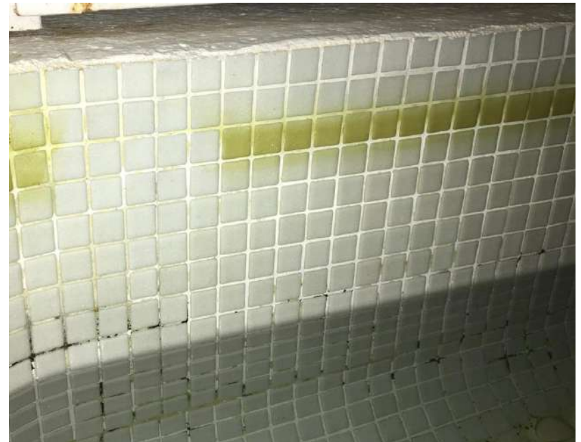
Después de tratamiento con G200 ÓXIDO
