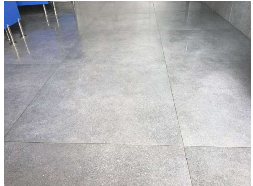
Después de tratamiento con G200 ÓXIDO
