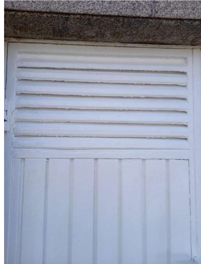
Después de tratamiento con G200 ÓXIDO
