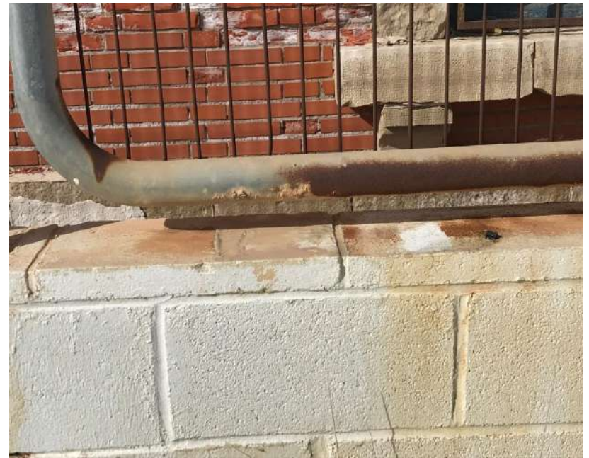
Después de tratamiento con G200 ÓXIDO
