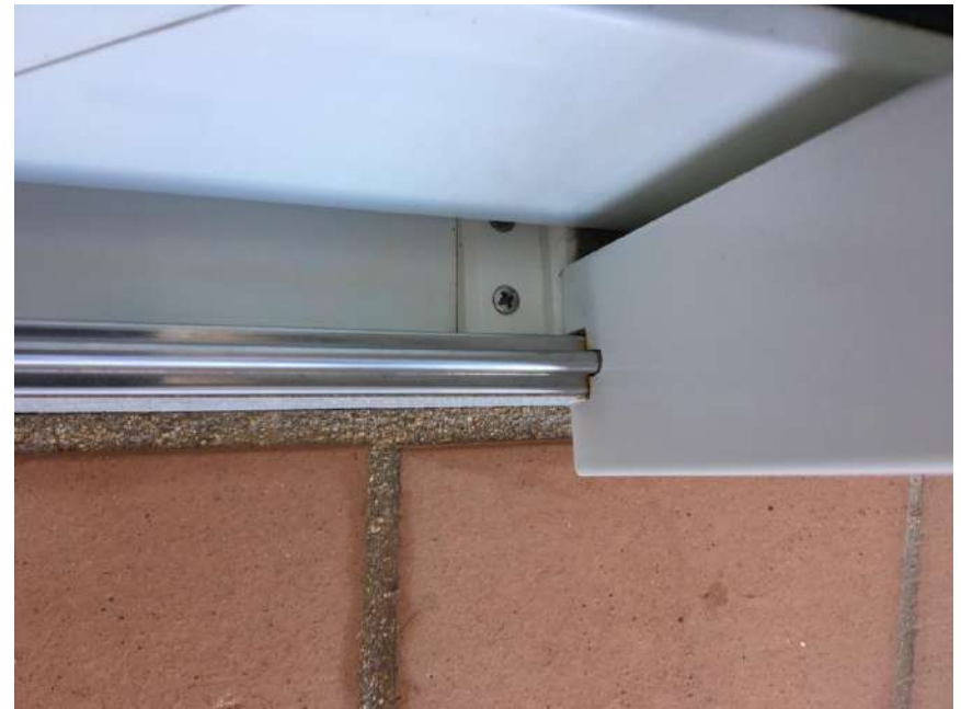
Después de tratamiento con G200 ÓXIDO
