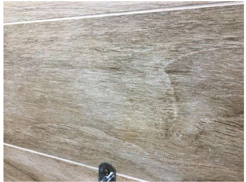
Después de tratamiento con G200 ÓXIDO
