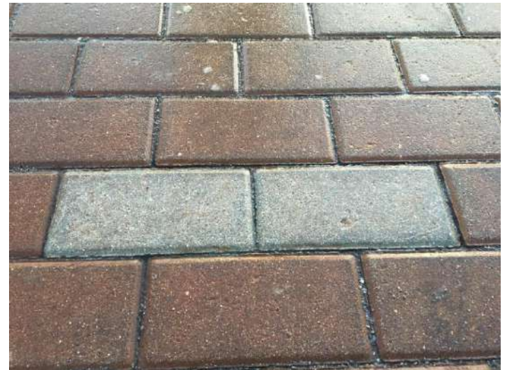
Después de tratamiento con G200 ÓXIDO
