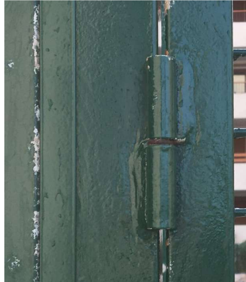
Después de tratamiento con G200 ÓXIDO
