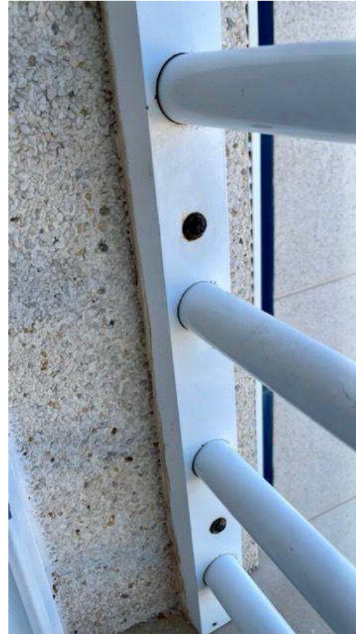
Después de tratamiento con G200 ÓXIDO
