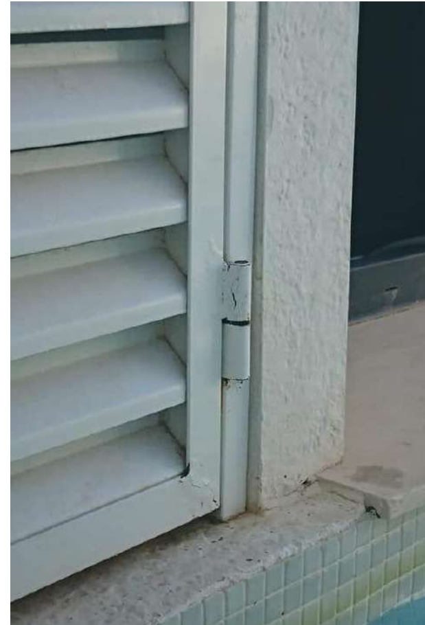
Después de tratamiento con G200 ÓXIDO
