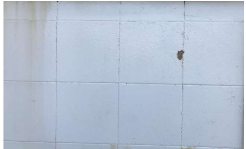
Después de tratamiento con G200 ÓXIDO
