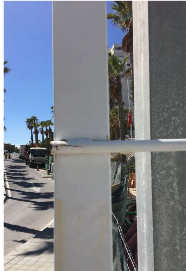
Después de tratamiento con G200 ÓXIDO
