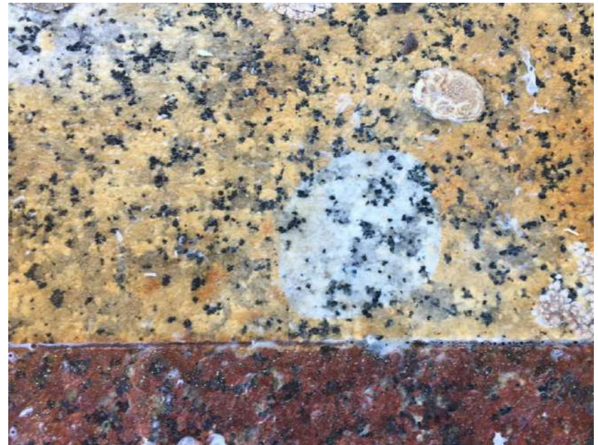
Después de tratamiento con G200 ÓXIDO
